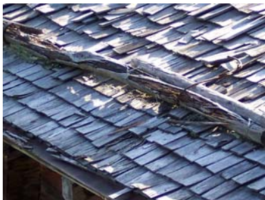
Verfaulte Schindeln und Schneehalter
